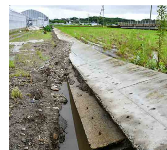
河川の氾濫で倒壊した防水設備
