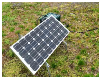
端末はソーラー電源で稼働
