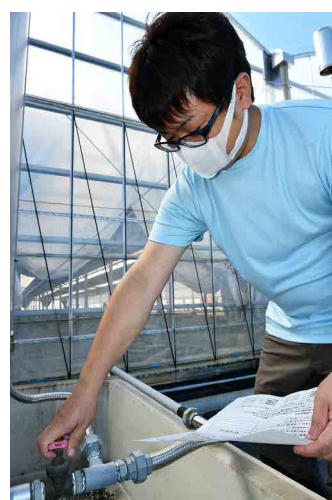
点検表を手に重油タンクのパルプを確認する組合員
